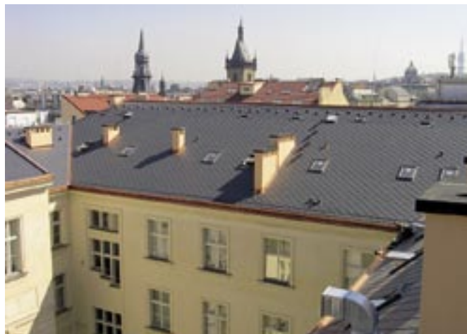
Rekonstrukce budovy ČVUT v Praze. Oprava a z části výměna krovové konstrukce, výměna střešního pláště a klempířských konstrukcí, vnitřní dřevěné podlahy aj.
