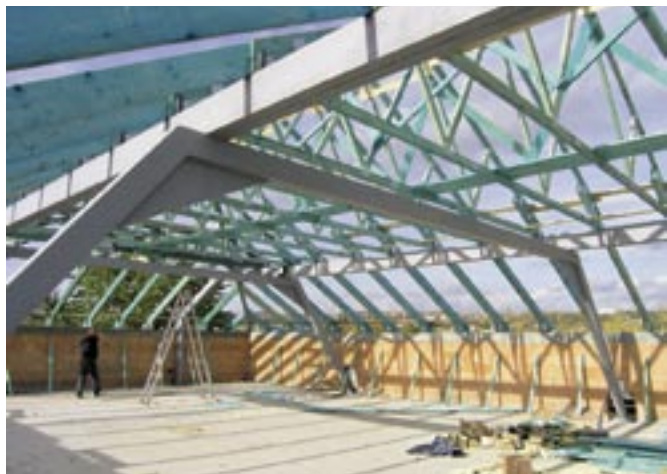
Realizace střešní vazníkové konstrukce administrativního objektu v Praze. Kombinace s nosnými ocelovými rámy. Valbová střecha o rozměrech 13,7 × 31,4 m.
